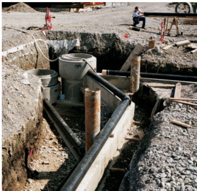
Abb. 12: Abwasserprojekt Hohenems in Vorarlberg, Österreich
