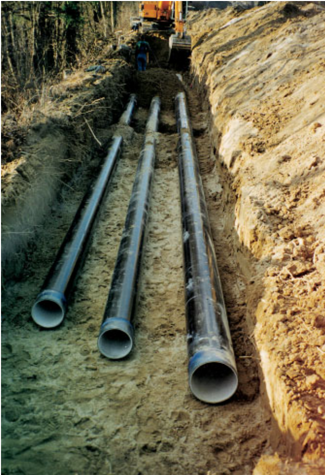
Abb. 13: Rohre mit Einsteckschweißmuffenverbindung für die Pumpendruckleitung in Rosegg, Kärnten
