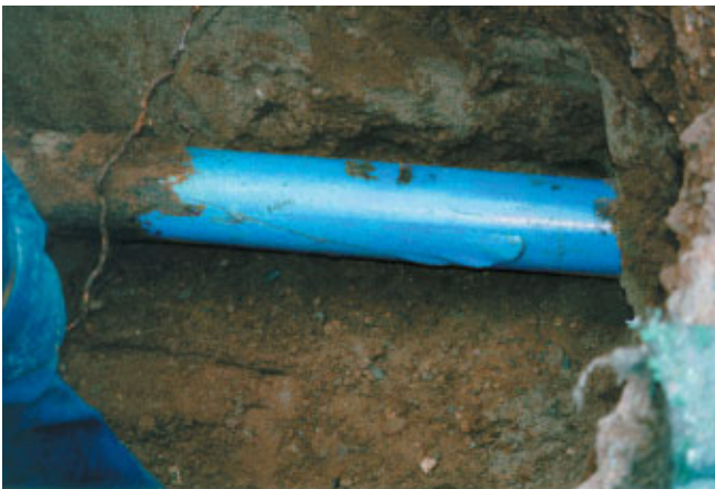
Abb. 3 und 4: Durch Arbeiten im Trassenbereich verursachte Umhüllungsschäden einer Stahlrohrleitung
