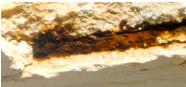
Abb. 1: Schädigung des Werkstoffverbundes aus Stahl und Beton aufgrund zu geringer Überdeckungen
