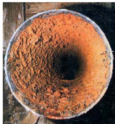
Abb. 2: Inkrustationen auf ungeschützten Rohrinnenflächen
