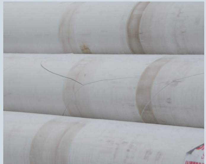
BILD 2: Schaden an einer PP-Umhüllung auf dem Rohrlager
