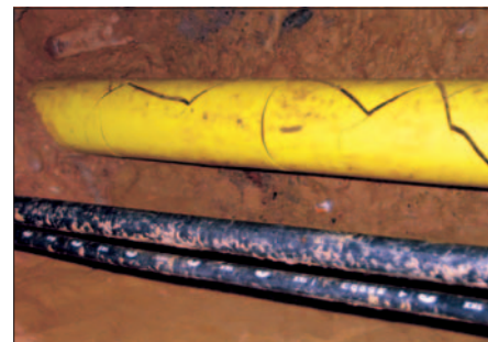
Bild 3: Durch Versprödung geschädigte Polyethylenumhüllung Fig. 3: Polyethylene coating damaged by embrittlement
