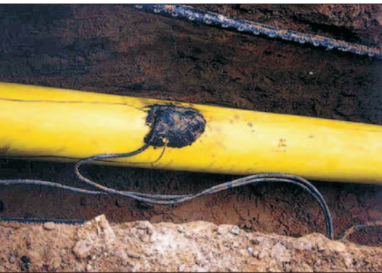
Bild 5: Erscheinungsbild der Spannungsrisse als Sekundärschädigung einer mangelhaft ausgeführten Nachumhüllung von Anschlüssen für den kathodischen Korrosionsschutz
