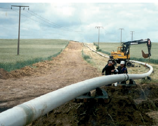
Bild 8: Wesenberg, DN 300, Bauj.1996 Fig. 8: Wesenberg, DN 300, installed 1996
