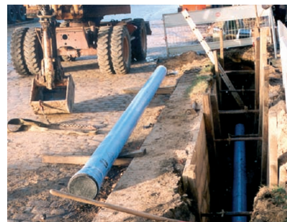
Bild 9: Hamburg, DN 200, Bauj. 2000 Fig. 9: Hamburg, DN 200, installed 2000
