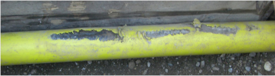
Bild 2: Baggerzahnangriff – Schadensbild einer Stahlrohrleitung
